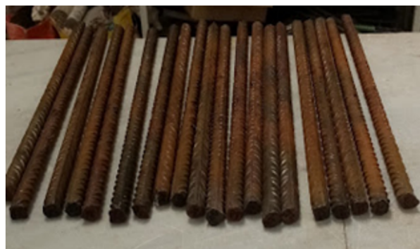
Figura 8: Aceros al carbono corroídos
